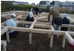
木造応急仮設住宅の早期供給に向けた訓練のイメージ
