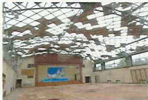
台風で屋根が消失した体育館
