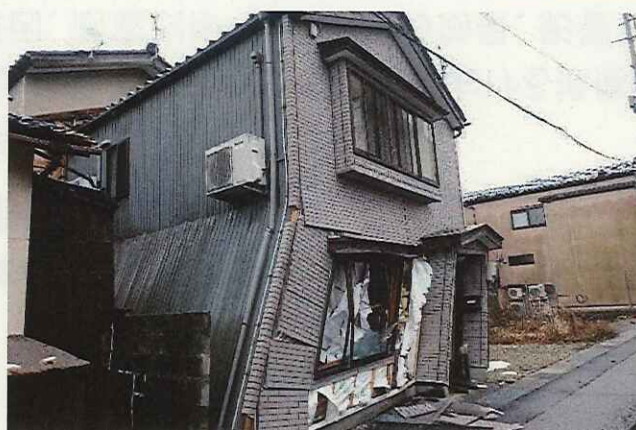
<木造住宅の被害>
