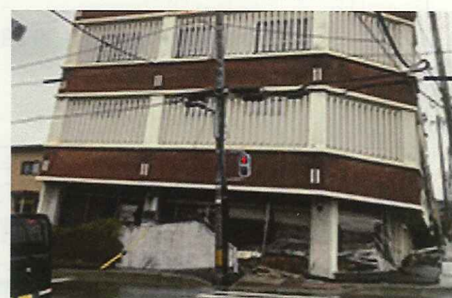
<建築物の傾斜被害>
