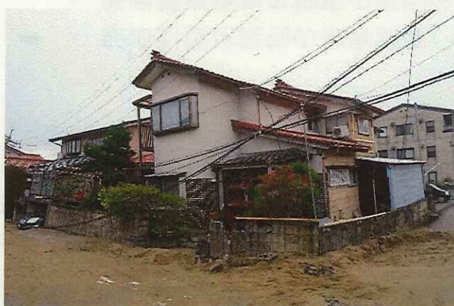
＜地盤液状化被害＞
