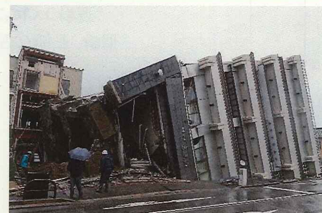
＜建築物の転倒被害＞
