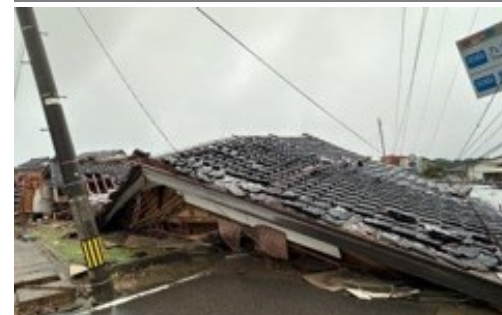
倒壊した木造建築物
